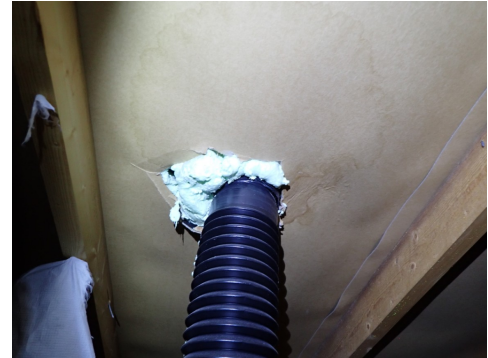
Fuktskjold rundt rør, lite fagmessig tetting rundt åpning
