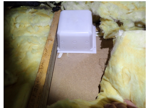
Lite isolasjon og manglende diffusjonssperre over bad
