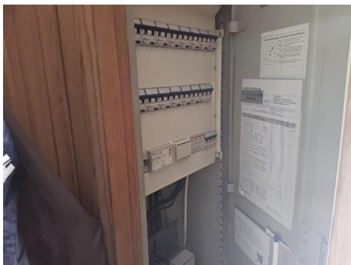
Elektrisk anlegg - [Sikringsskap med kursoversikt plassert i
