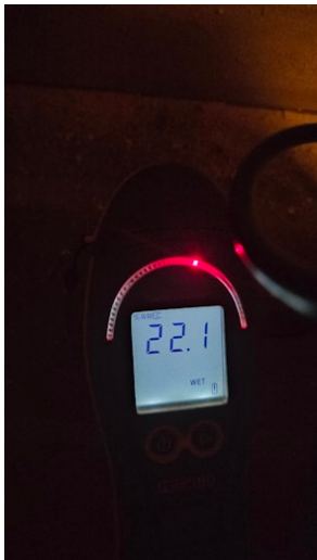
Fuktutslag i påforet kjellervegg
