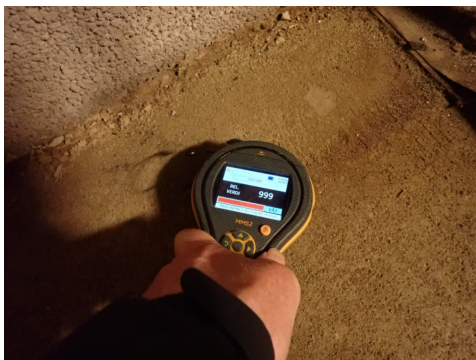
Fuktsøk på gulv
