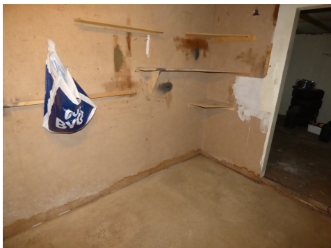
Eksempel på fuktmerker ved gulv
