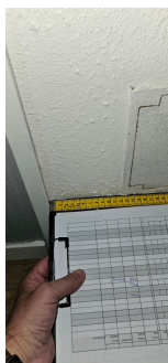
Ca 13 cm avstand feieluke - brennbart materiale.
