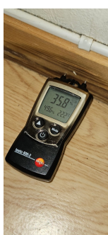
Fuktmåling fra tilstøtende soverom
