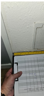
Ca 13 cm avstand feieluke - brennbart materiale.
