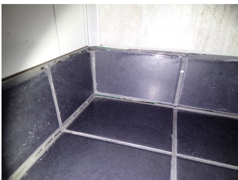
Oppsprekking mellom gulv/vegg, her i hjørne mot gang-stue/kjøkken
