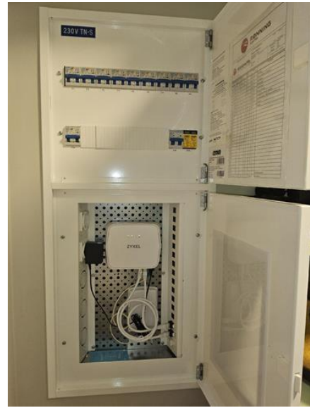
Elektrisk anlegg - [Sikringskap ]
