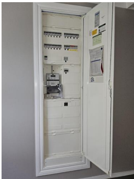
Elektrisk anlegg - [Sikkeringskap]
