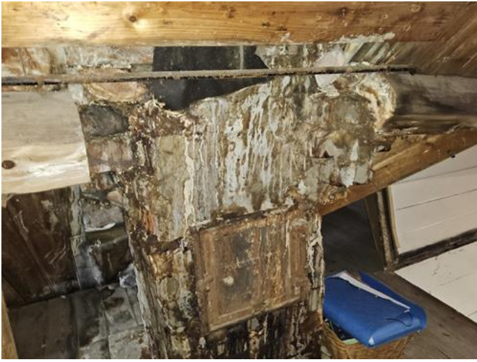
Loft - uinnredet / råloft - [Fuktmerker skorstein kaldtloft. ]
