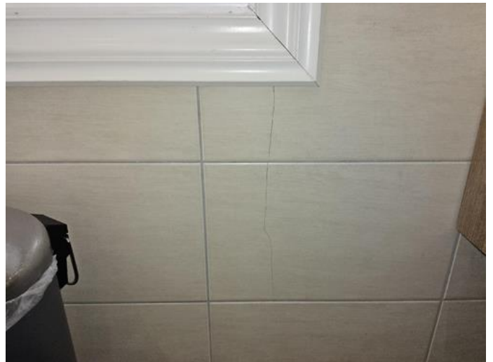
Våtrom - [Sprekker bad 2.etg.]
