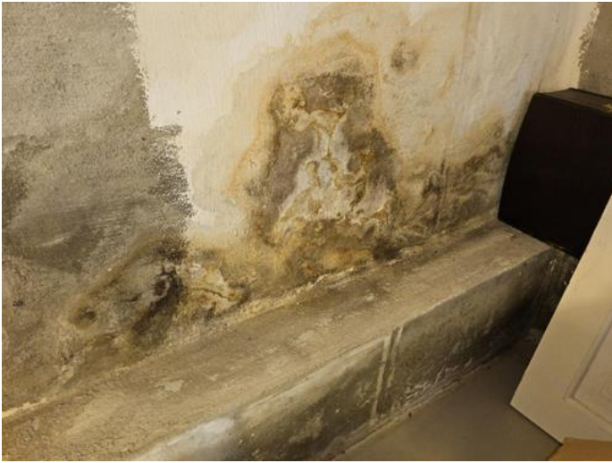
Rom under terreng (kjeller, underetasje, sokkeletasje) - [Fuktskjolder/soppvekster U.etg.]
