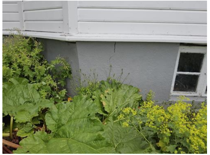
Grunnmur, fundamenter - [Sprekker på grunnmur. ]
