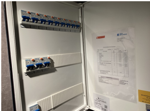
Bilde av sikringskap
