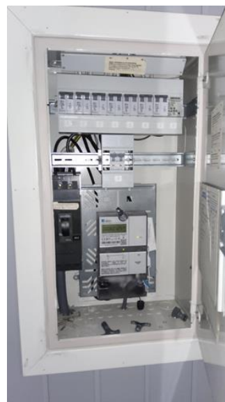
Elektrisk anlegg - [Sikringsskap plassert i entré]
