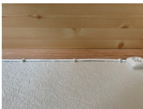
Viser ufagmessig opplegg av kabel.
