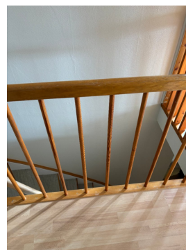
Viser store åpninger i rekkverk.
