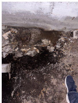
Viser krypkjeller med vanninnsig.
