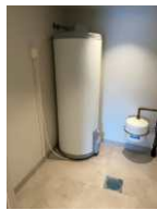
Varmtvannsbereideren er plassert på teknisk rom.
