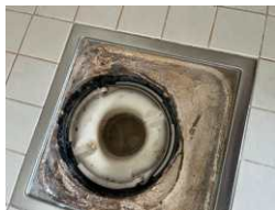
Sluket i gulvet på baderommet i første etasje.
