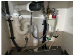
Automatisk vannstopper i kjøkkenbenken.
