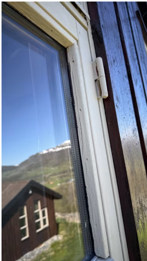
Eksempelbilde på malingsavflass/ værslitasje.
