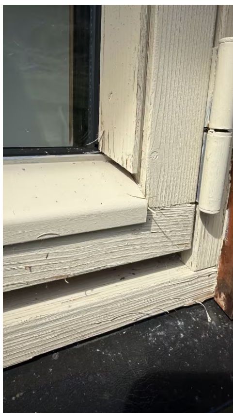
Eksempelbilde på malingsavlass/ værslitasje.
