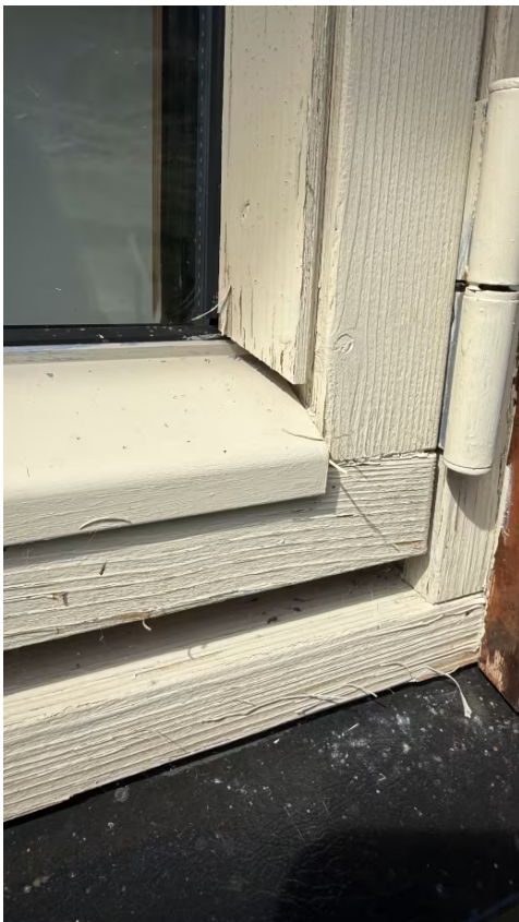
Eksempelbilde på malingsavlass/ værslitasje.
