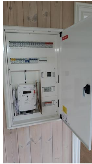
Elektrisk anlegg - [Sikringskap]
