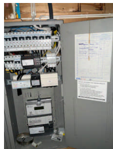
Sikringskap i trapperom.
