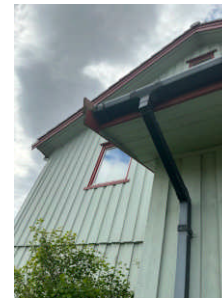
Takrenner i plast bolig.
