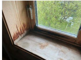
Fuktskader/merker i foringer innvendig på loft. Og fuktmerker i vinduskarm.
