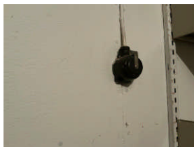
Kontakt som kan inneholde asbest.
