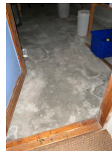
Det er slatutslag på gulv i kjeller.
