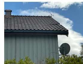
Takstein mangler på tak.
