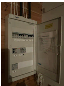
Sikringskap i garasje/bod.
