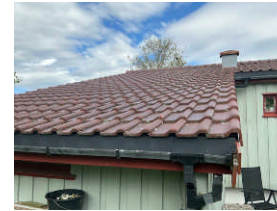
Takrenner i plast. Noe skjevheter i renne registreres.
