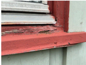
Råteskade i karm, vindu.
