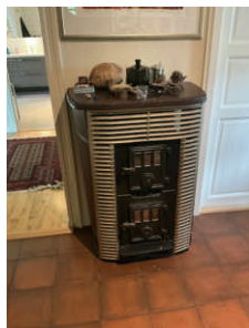
Vedovn med oljekamin. Oljekamin er ikke tilkoblet oljetank.
