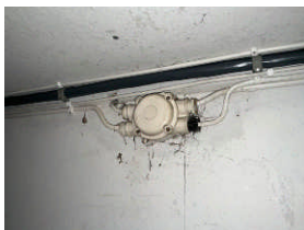
Koblingsboks som kan inneholde asbest.
