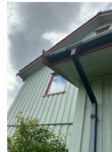
Takrenner i plast bolig.
