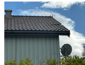
Takstein mangler på tak.
