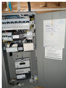
Sikringsskap i trapperom.
