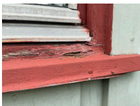
Råteskade i karm, vindu.
