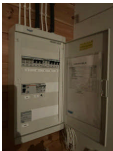
Sikringsskap i garasje/bod.
