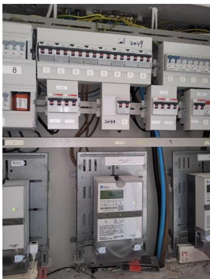
Elektrisk anlegg - [Sikringsskap merket 3049]
