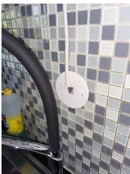
Elektrisk anlegg - [Manglende isolasjon på ledning kjøkken. ]
