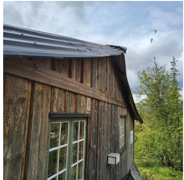
Utvendig - [Eksempel på skadet takutstikk]
