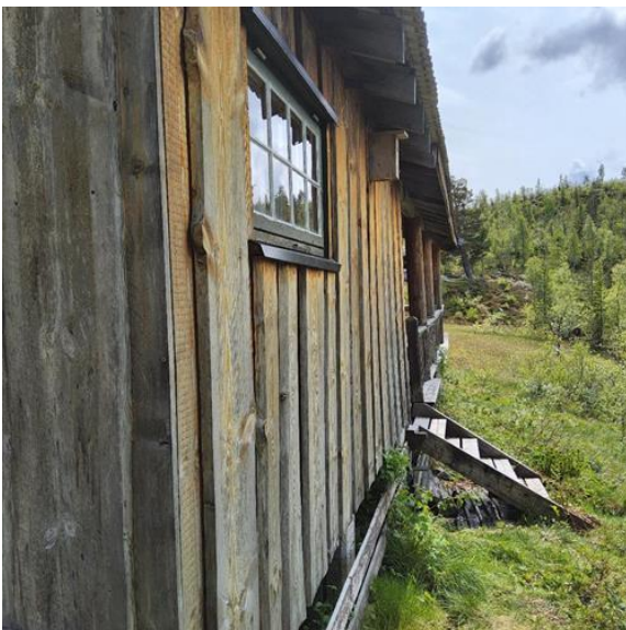
Utvendig - [Eksempel på slitasjer]
