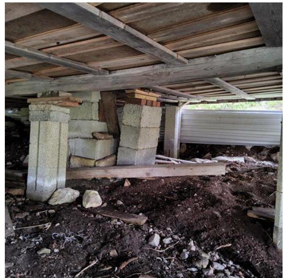
Utvendig - [Eksempel på skjevheter og ufagmessig utførelser]
