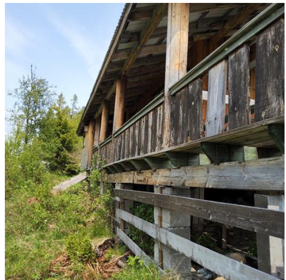
Utvendig - [Eksempel på slitasjer]
