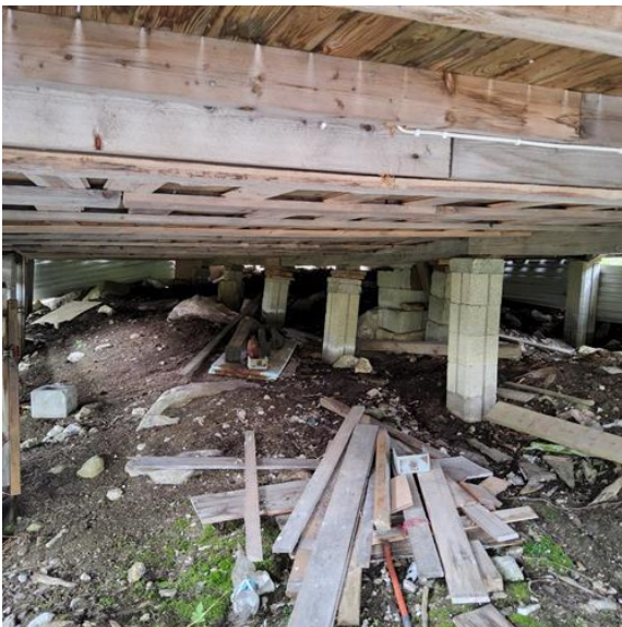
Utvendig - [Eksempel på skjevheter i konstruksjonen og fundamenter]
