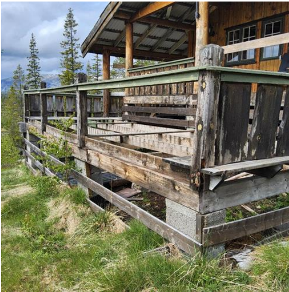
Utvendig - [Eksempel på veranda med skjevheter og skader]
