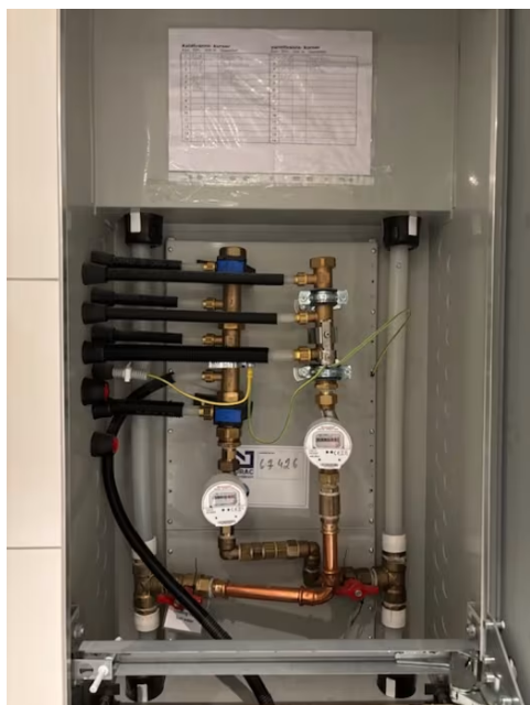
Rørfordelerskap med stoppekran plassert i bad/vaskerom.
