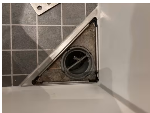
Baderomssluk plassert i dusjsone.
