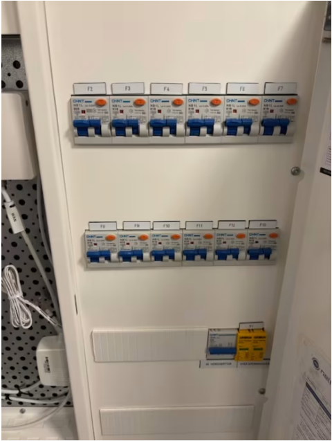
Sikringsskap med automatsikringer plassert i bod.
