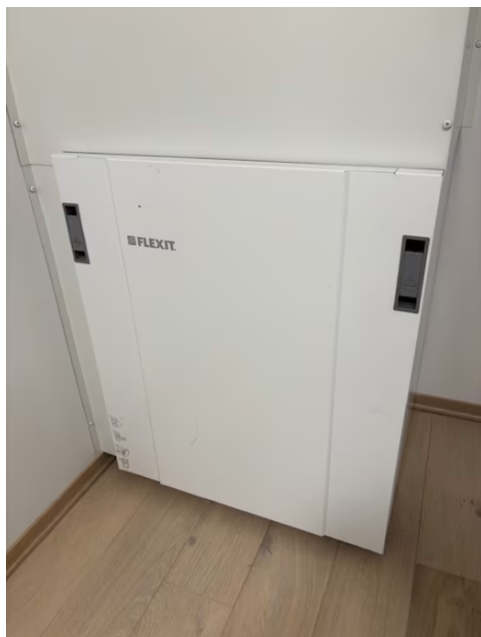
Ventilasjonsaggregat plassert i boden.
