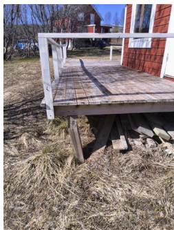
Annet - Slitasje og skjevheter i terrasse
