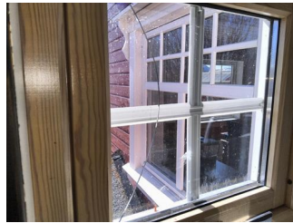
Vinduer og omramming - Sprukket vindu på bad
