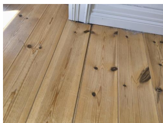
Overflate gulv - Glippe i gulv
