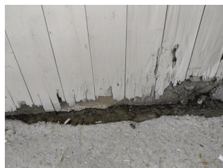
Overflate vegg - Synlige råteskader i panel
