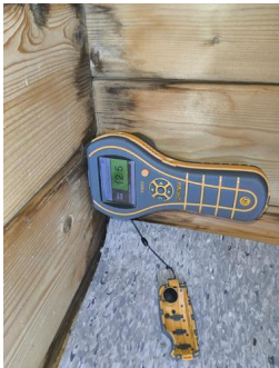
Veggkonstruksjon og fasadematerialer - Fuktmerker i hjørner
