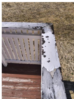
Tilstand på rekkverk og overflatematerialer - Slitasje på rekkverk og terrassebord
