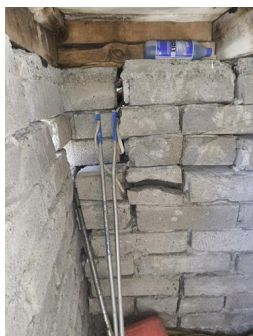
Fundament, grunnmur og gulv mot grunn - Setningsskader i grunnmur
