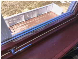
Vinduer og omramming - Slitt overflatebehandling
