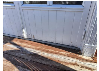
Ytterdører og omramming - Slitasje og symptomer på fuktoppsug
