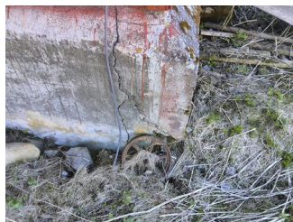
Fundament, grunnmur og gulv mot grunn - Sprekker i grunnmur
