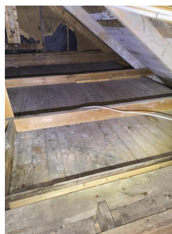
Ventilasjon, oppbygning og materialbruk - Uisolert
