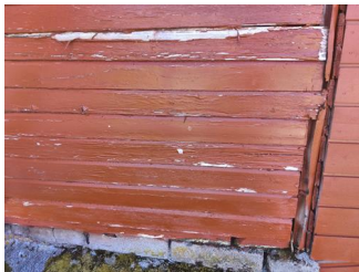
Veggkonstruksjon og fasadematerialer - Slitt overflatebehandling
