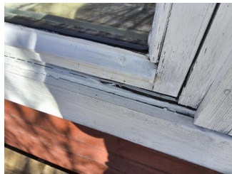
Vinduer, dører og porter - Slitasje og sprekk i vinduskarm
