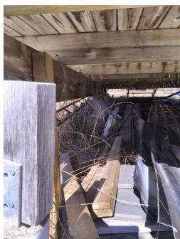
Konstruksjon og fundamenter - Skader i fundament/søyler
