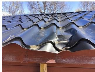
Yttertak og takkonstruksjon - Skader i takplate
