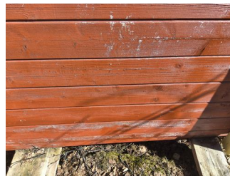
Veggkonstruksjon og fasadematerialer - Slitt overflatebehandling
