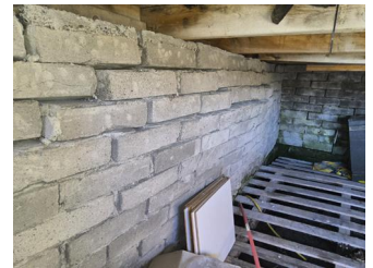
Fundament, grunnmur og gulv mot grunn - Setningsskader i grunnmur
