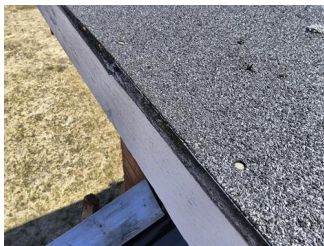
Tekking (med tilhørende beslag) - Manglende vindskibord og lekkasjesikring på flatt tak
