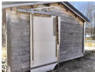
Veggkonstruksjon og fasadematerialer - Manglende overflatebehandling
