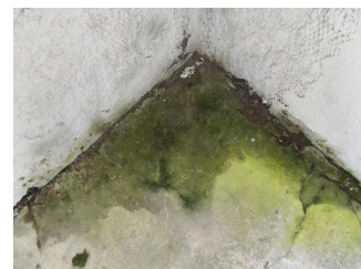
Overflate vegg - Synlige symptomer på fukt
