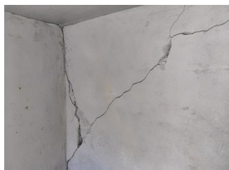
Overflate vegg - Sprekk i innervegg
