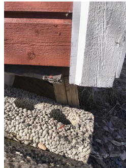
Fundament, grunnmur og gulv mot grunn - Skjevhet i søyler
