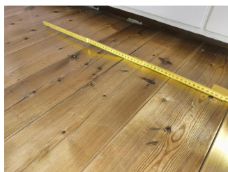
Overflate gulv - Ugjevnheter og sprekker i gulv foran kjøkkenvask
