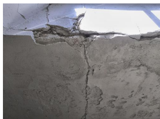
Overflate vegg - Sprekk i yttervegg og avskalling av murpuss
