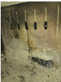
Ildsteder - Sprekk i bakplate
