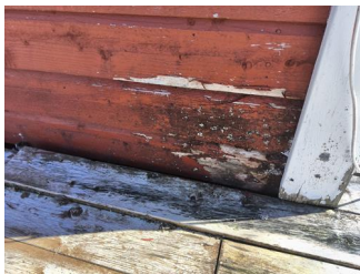
Veggkonstruksjon og fasadematerialer - Utvendig slitasje i kledning
