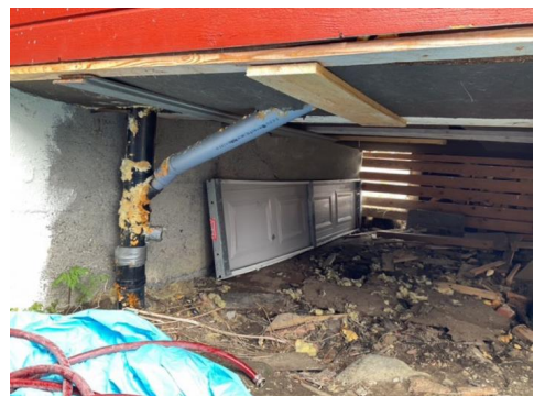
Avløpsrør av plast fra 2005 under badet.
