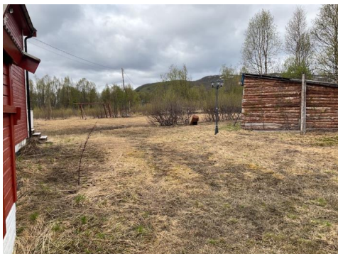
Terrenget på nordsiden av boligen. For lite fall fra muren.
