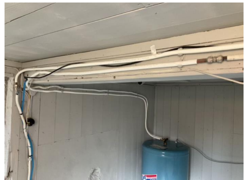
Vannledninger av kobber med plastkappe.
