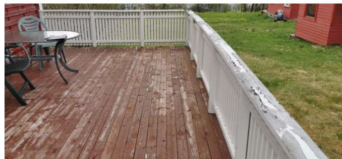
Håndlist er malingsslitt. Plattingen trenger behandling.
