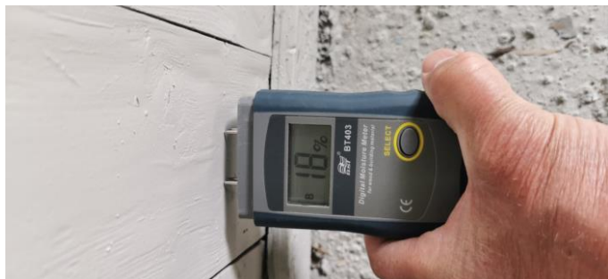
18 vektprosent fuktinnhold i veggpanel i kjelleren.
