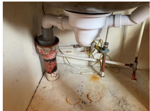
Avløpsrør av plast og støpejern i kjøkkenbenken.
