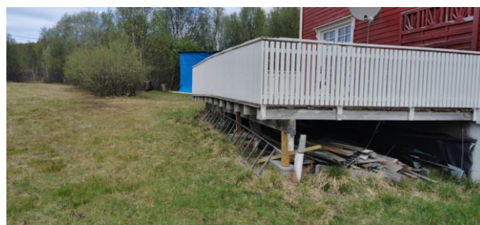
Det er noe setninger i fundamenter til terrassen. Fundamentene må repareres.
