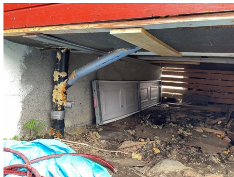
Avløpsrør av plast fra 2005. Direkte til septik.
