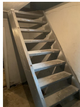
Rekkverk og håndløper mangler.
