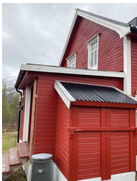
Malt balkongdør fra 2005 på soverom på loft. Døra må blokkeres på grunn av manglende rekkverk på taket!
