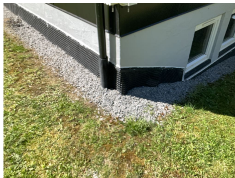
Grunnmursplast over terreng.
