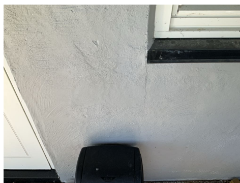
Noe riss i grunnmur.
