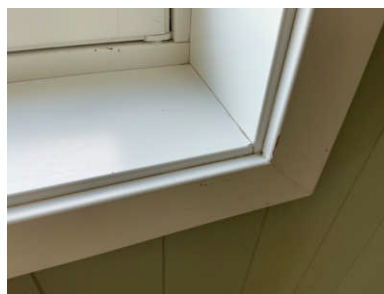
Fuktskader i vindusforing.
