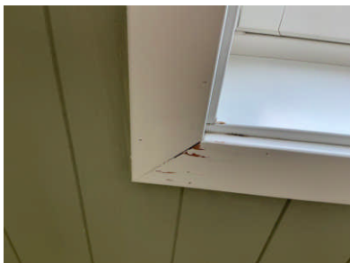
Listverk med avflasket maling på soverom og fuktskader i vindusforing.
