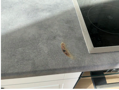
Skade i benkeplate ved platetopp.
