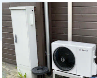
varmepumpe og inntaksskap
