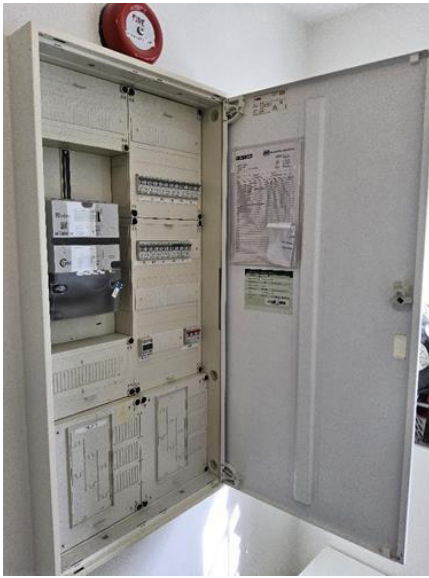
Elektrisk anlegg - [Sikringskap. ]
