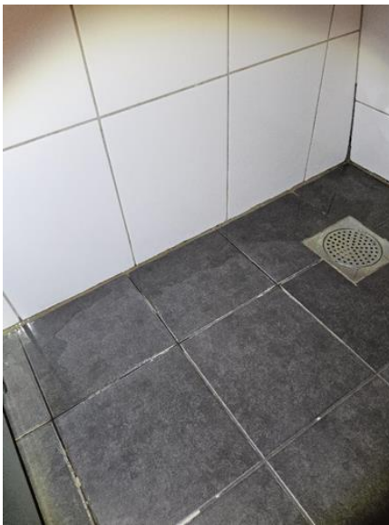
Våtrom - [Vannansamling i dusjonen. ]
