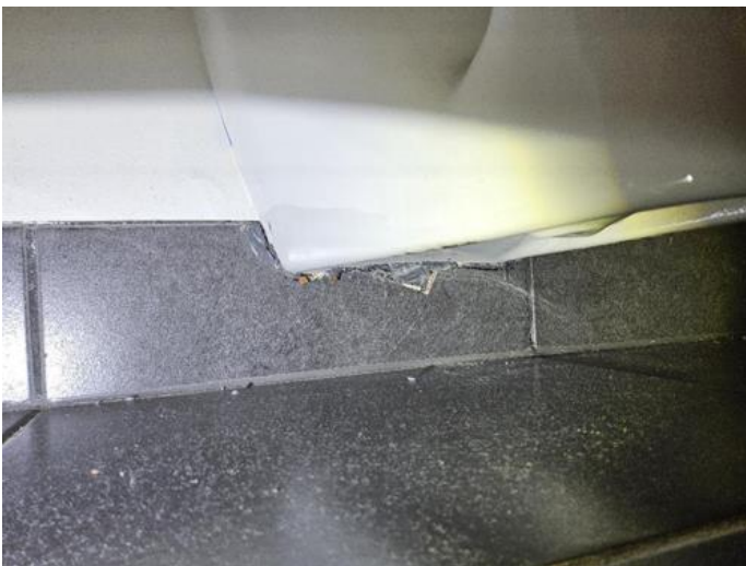
Våtrom - [Sprekk i flis under toalett. ]
