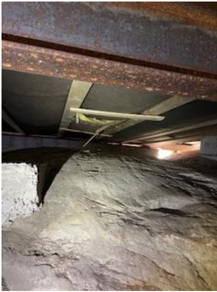
Innvendig - [Eksempel på skade/åpning i stubloftkonstruksjon i krypkjeller]
