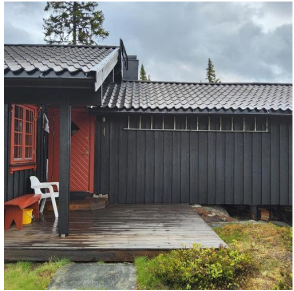
Utvendig - [Manglende snøfangerutstyr over inngangsparti]
