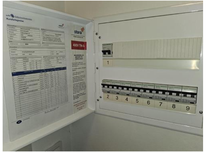
Elektrisk anlegg - [Sikringsskap og kursfortegnelse ]
