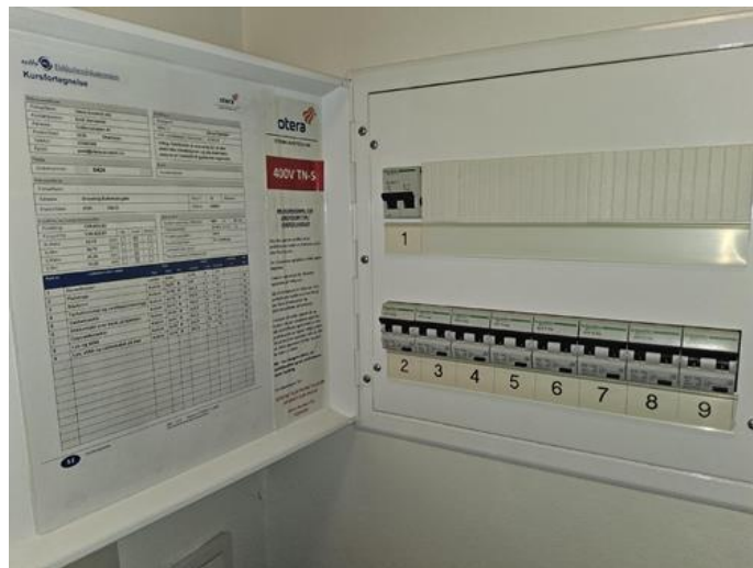
Elektrisk anlegg - [Sikringsskap og kursfortegnelse]
