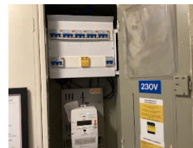
Bilde av sikringskap
