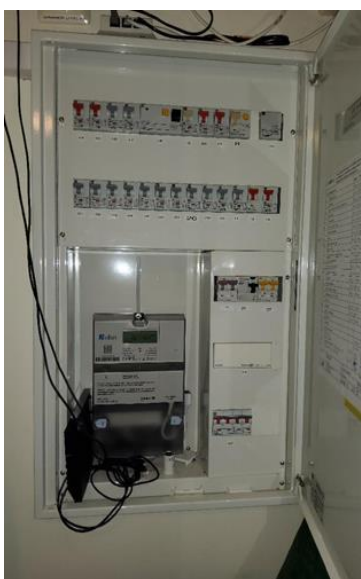
Elektrisk anlegg - [Sikringsskap]
