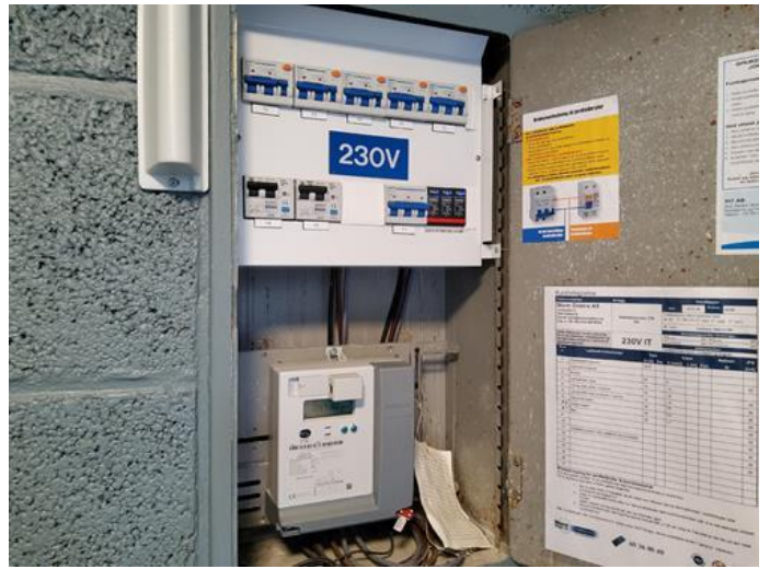
Elektrisk anlegg - [Sikringskap ]
