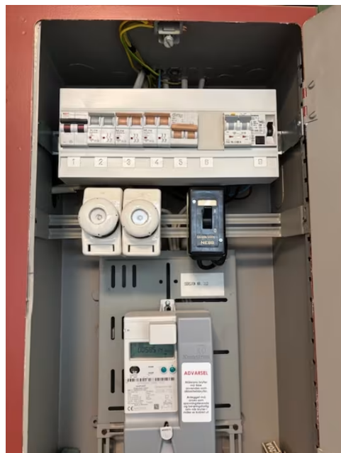
Sikringsskap med plassert i felles trappoppgang.
