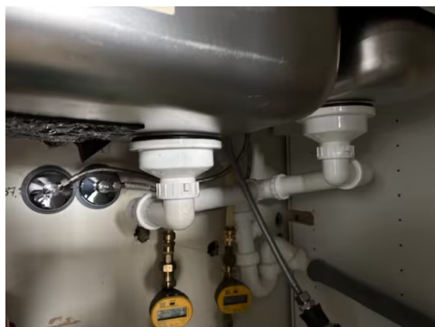
Avløpsrør i underskap vask på kjøkkenet.
