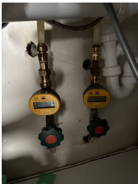
Vannmåler lett tilgjengelig og synlig plassert under vask på kjøkkenet.
