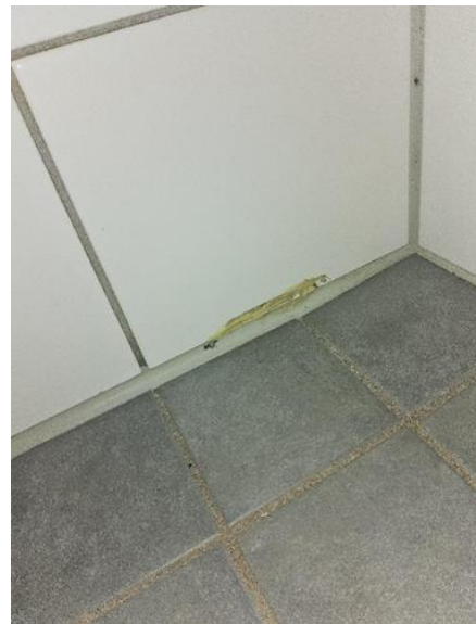
Våtrom - [Skade på flis i dusjsonen (hybel)]
