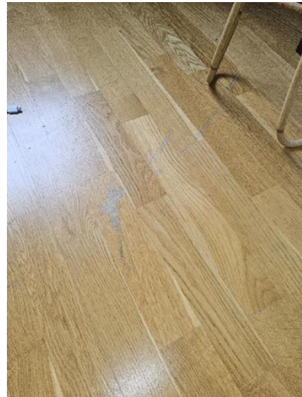
Overflater gulv - [Merke på gulv i stue (hybel)]
