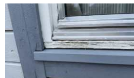
Eksempelbilde på værslitasje/ malingsavflass.
