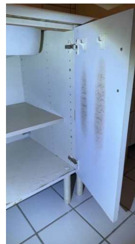
Skader/ svellinger på baderomsinnredningen.
