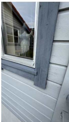
Eksempelbilde på værslitasje/ malingsavflass.
