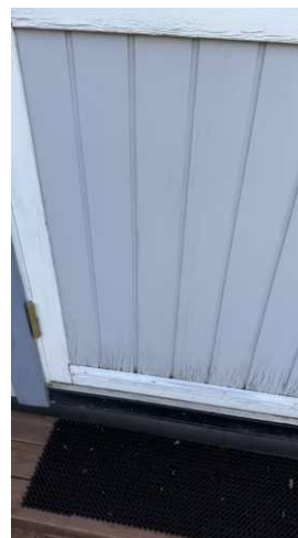
Eksempelbilde på værslitasje/ malingsavflass.
