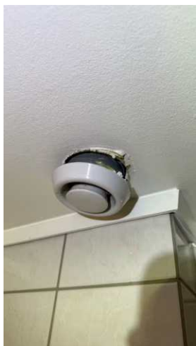
Avtrekk er ikke tilstrekkelig festet.
