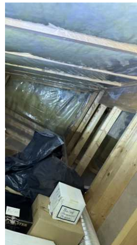
Ikke tilfredsstillende klemming/ tetting av dampsperre ved tretrager.
