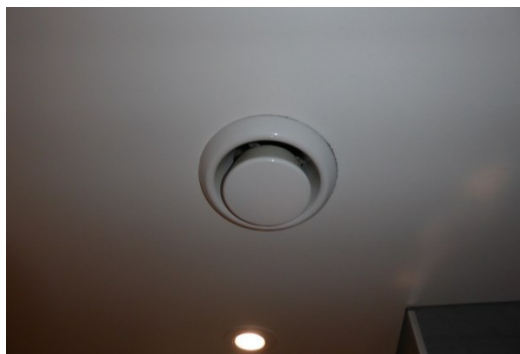
Avtreksventil på ventilasjonsanlegget.
