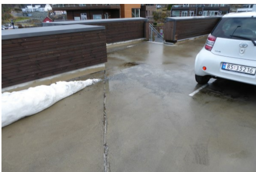
Stående vann på dekket ved biloppstillingsplasser.
