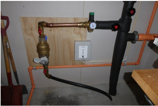
Vanninnlegg med reduksjonsventil og trykkmåler.
