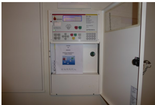
Sentral for brannvarslingsanlegg.
