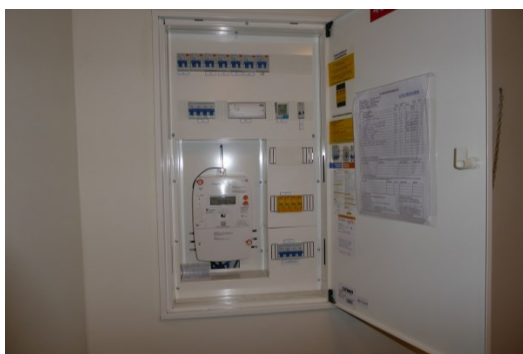
Fordelerskap for fellesarealer i et av byggene.
