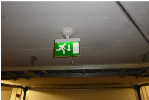
Nød- og ledelys plassert i garasjeanlegg.
