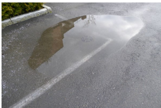
Vannansamling ved tett overvannssluk.
