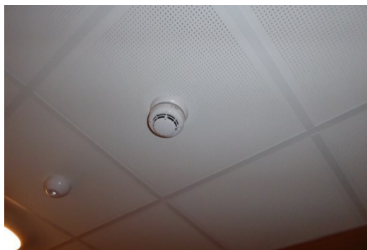
Røykdetektor tilknyttet alarmanlegg.
