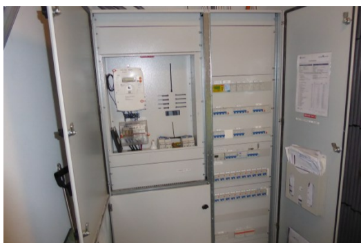
Hovedfordelingstavle med el-inntak.
