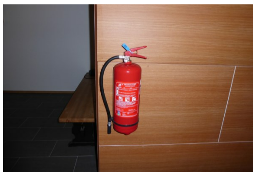
Pulverapparat for manuell slukning på fellesareal.
