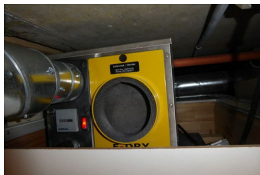
Bildet viser aggregatet innebygget i kasse.
