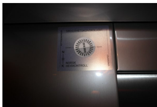
Bildet viser skilt med gjennomført kontrollpåskrift.
