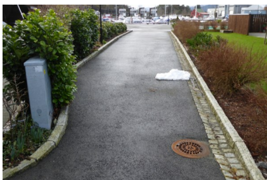
Renne langs kantstein som fører til overvannssluk.
