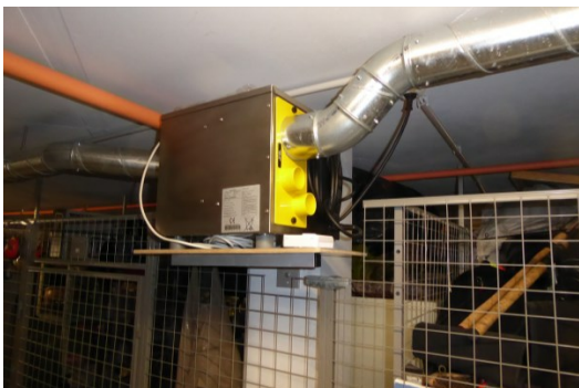
Plassering av adsorpsjonsavfukter i bodarealer Kompasset.
