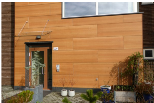
Veggparti med fasadeplater - stedvise flekker fugleskitt.
