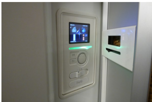
Styringspanel på avtrekksvarmepumpa.
