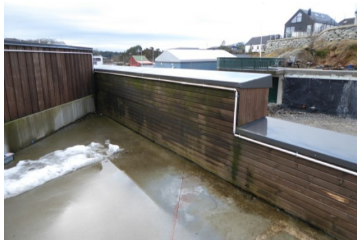
Parti på parapetvegg ved biloppstillingsplasser med grønske.
