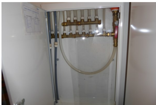
Fordelingsskap med hovedstoppekran i leilighet.
