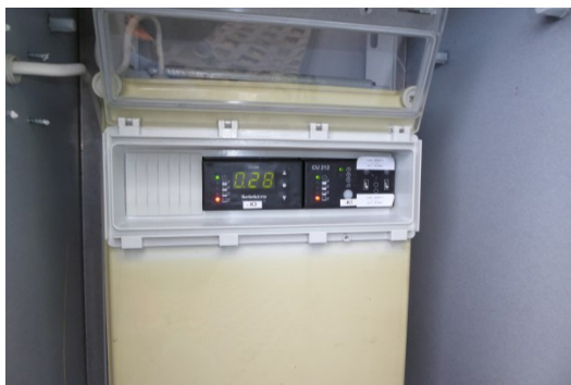
Styringsenheten for pumpeanlegget.
