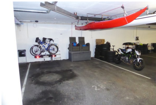
Lekkasjepunkt i garasje, med provisorisk renneløsning.
