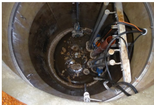
Pumpekum med pumper.
