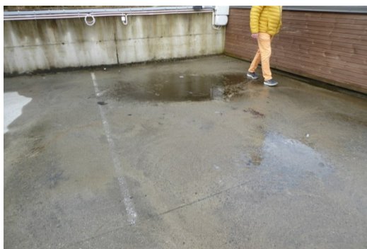
Stående vann på dekket ved biloppstillingsplasser.
