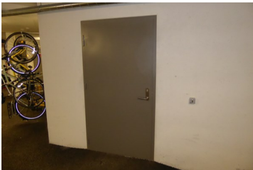
Brannør i stål mellom garasje og bodarealer.
