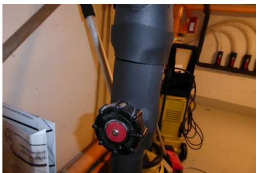
Hovedstoppekran på vanninnlegget i bygget.
