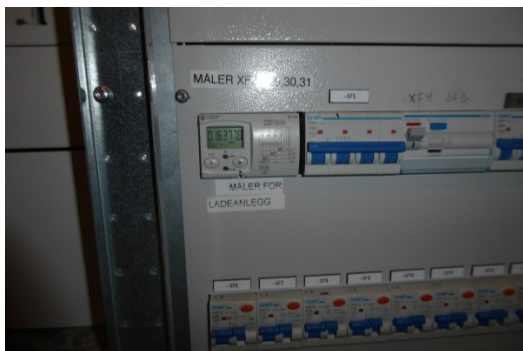
Måler for ladeanlegget el-bil.
