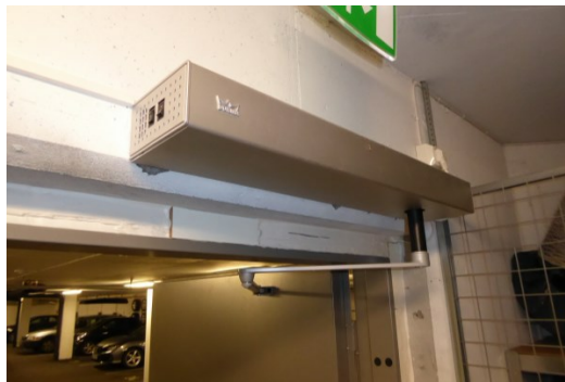
Elektrisk dørpumpe på brannør til garasjeanlegg.
