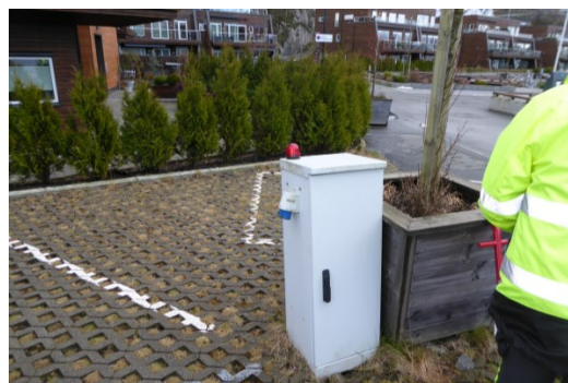
Styringsboks for pumpeanlegg, med visuell alarm.
