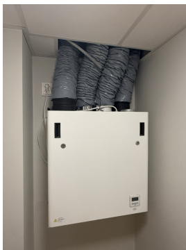
Balansert ventilasjonsaggregat, plassert i innebod.
