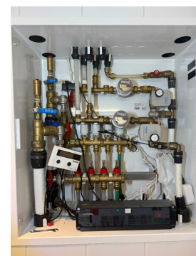
Rørskap i baderomsvegg med stoppekraner
