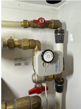
Stoppekraner til forbruksvann i rørskap
