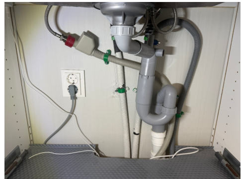
Rørøpplagg i kjøkkenbenk
