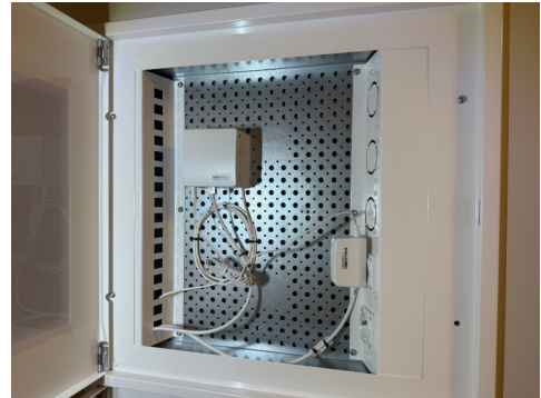
Innlagt fibernet, skap i innebod.
