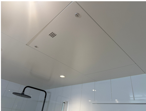
Rørskap for bad i baderomshimling
