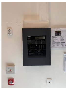
Felles brannvarslingsanlegg i bygget
