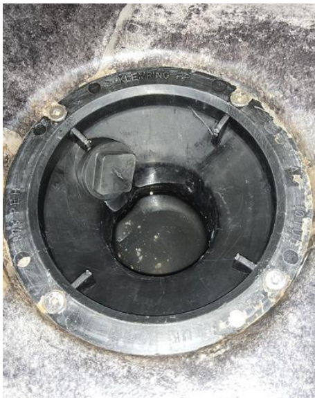
Avløpsrør (ink. sluk) - [Sluk bad i kjeller]
