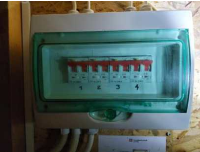
Elektrisk anlegg - [Sikringsskap]
