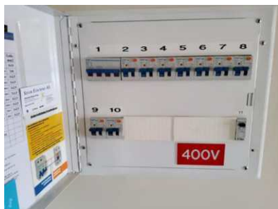
Elektrisk anlegg - [Sikringskap]
