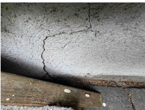
Sprekk i grunnmur
