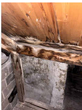
Viser fuktskjolder i tak på felles loft.
