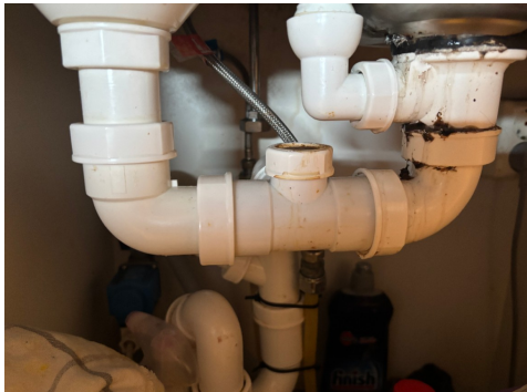
Viser rør i benkeskap.
