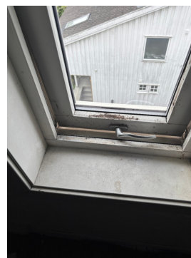
Viser muggsopp på vindu på loftsrom.
