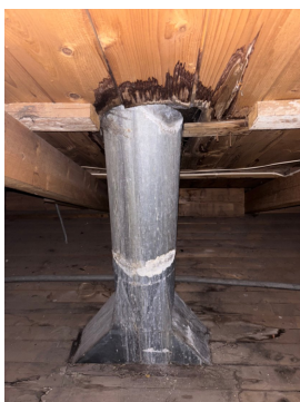
Viser fuktskjolder rundt rør på felles loft.
