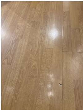
Viser skader i laminat + sprekker
