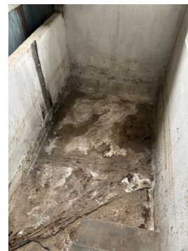
Viser fukt i gulv ogger i kjeller.
