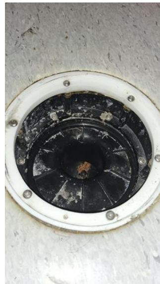
Avløpsrør (ink. sluk) - [Sluk vaskerom]
