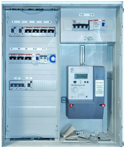
Forenklet vurdering av det elektriske anlegget - [Sikingskap]
