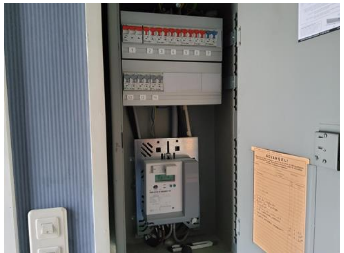
Elektrisk anlegg - [Sikringsskap ]
