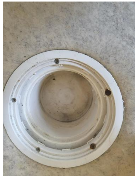
Slukets tilkomstmulighet for rengjøring - [Sluket på vaskerom ]
