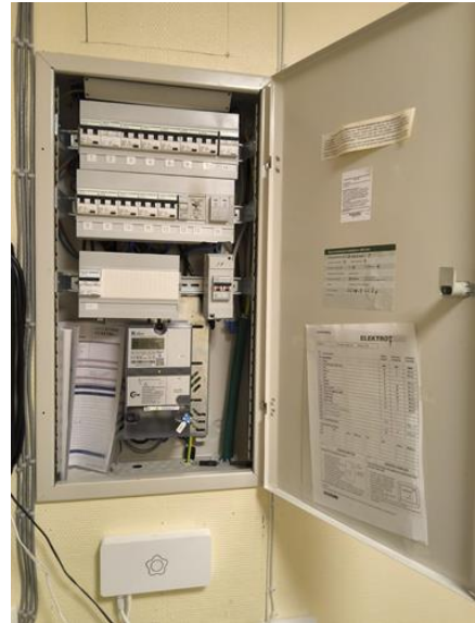
Elektrisk anlegg - [Sikringskapp boligen ]
