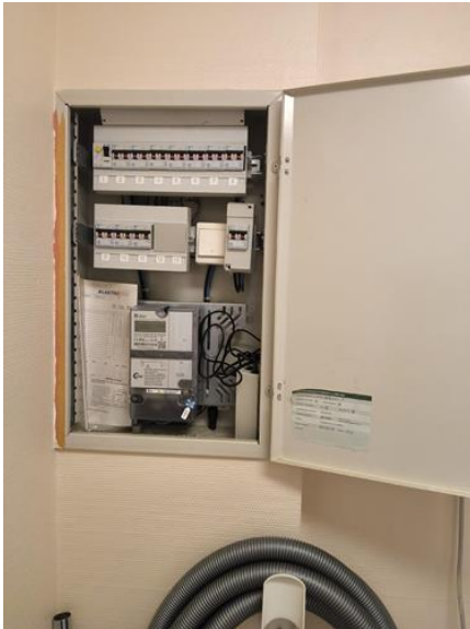
Elektrisk anlegg - [Sikringskapp i leilighet ]
