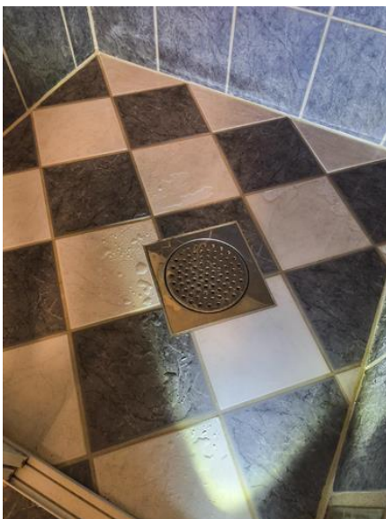
Fallforhold (gulv) - [Fallforholdet i dusjonen. Bad i]
