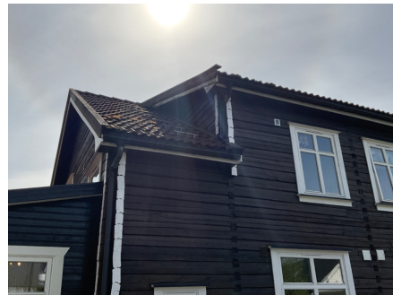
Manglende beslag mellom yttervegg og tekking.
