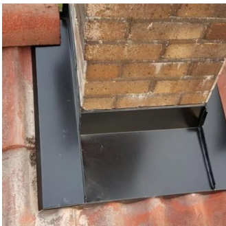
Bilde oversendt av eier, fra utbedring av pipebeslag. Bilde skal være tatt av utførende håndverker.
