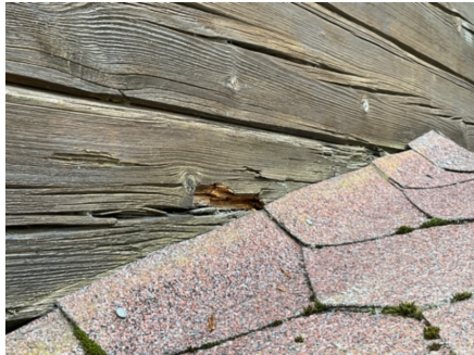
Noe punktvis råteskader som bør utbedres.
