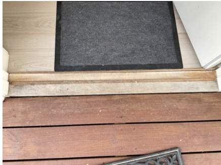
Mangler beslag under terskel.
