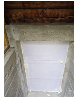
Sprekk i overdekning over tidligere dør.
