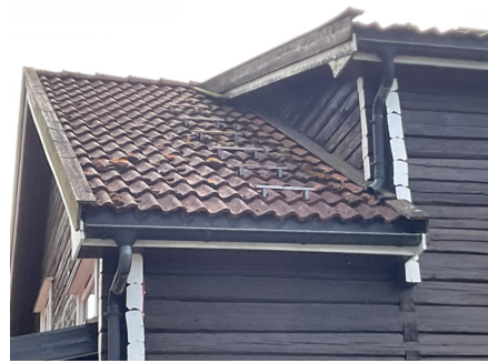
Mose og begroing på tekkingen.
