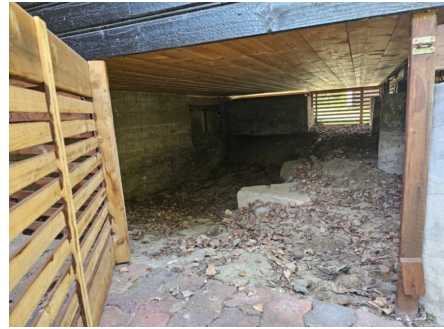
En grop under tilbygget. Eier opplyser at det ikke har oppdaget vannansamlinger.
