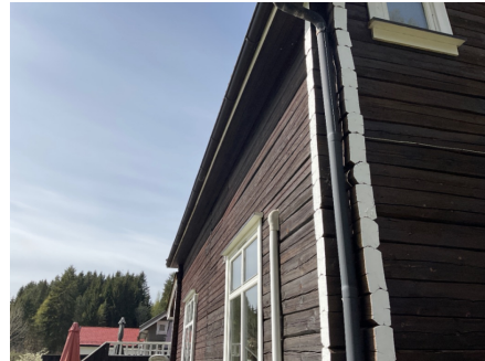
Ujevnheter i tømmerkonstruksjonen.
