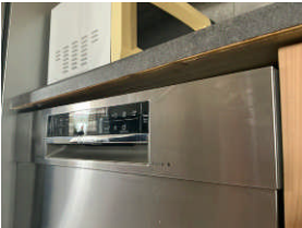
Det er fuktskader i benkeplate over oppvaskmaskin.
