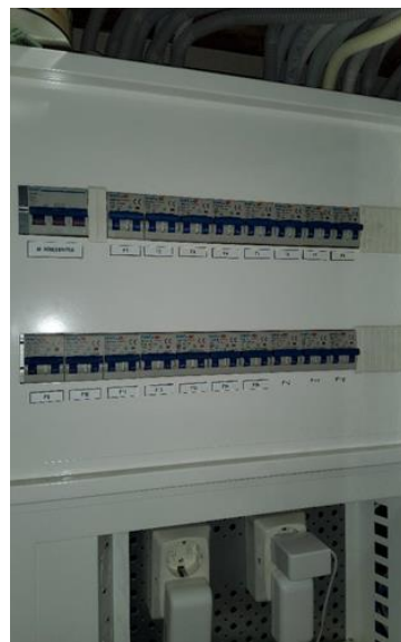
Elektrisk anlegg - [Sikringsskap]
