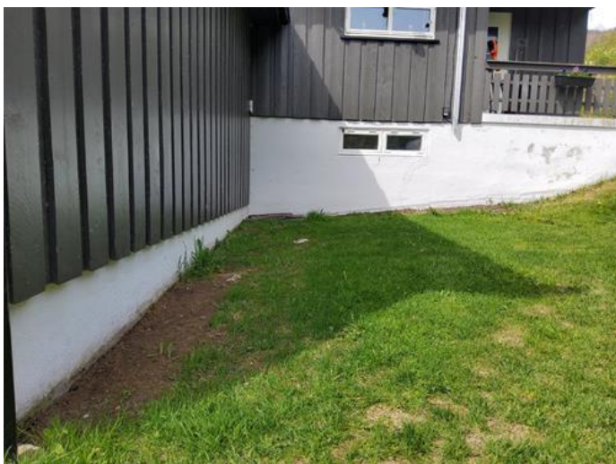
Beskrivelse - [Terreng heller mot grunnmur og krypekjeller]
