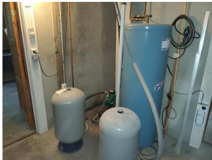
Beskrivelse - [Teknisk anlegg]
