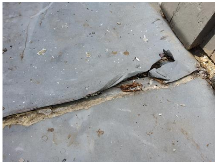
Kommentar - [Utettheter/skader i beslag på balkong]
