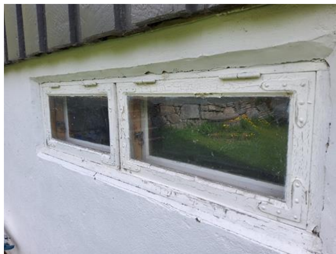
Beskrivelse - [Slitasje på kjellervinduer]
